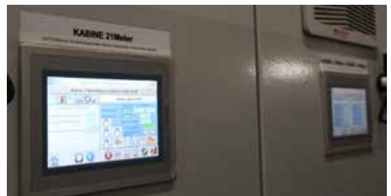
High-Tech: Die neuen Schaltschränke mit Bedien-
